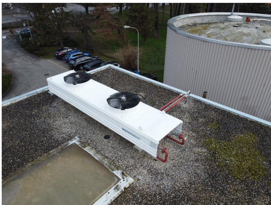
Aérefroidisseur de secours du CCF nécessitant un entretien ponctuel
