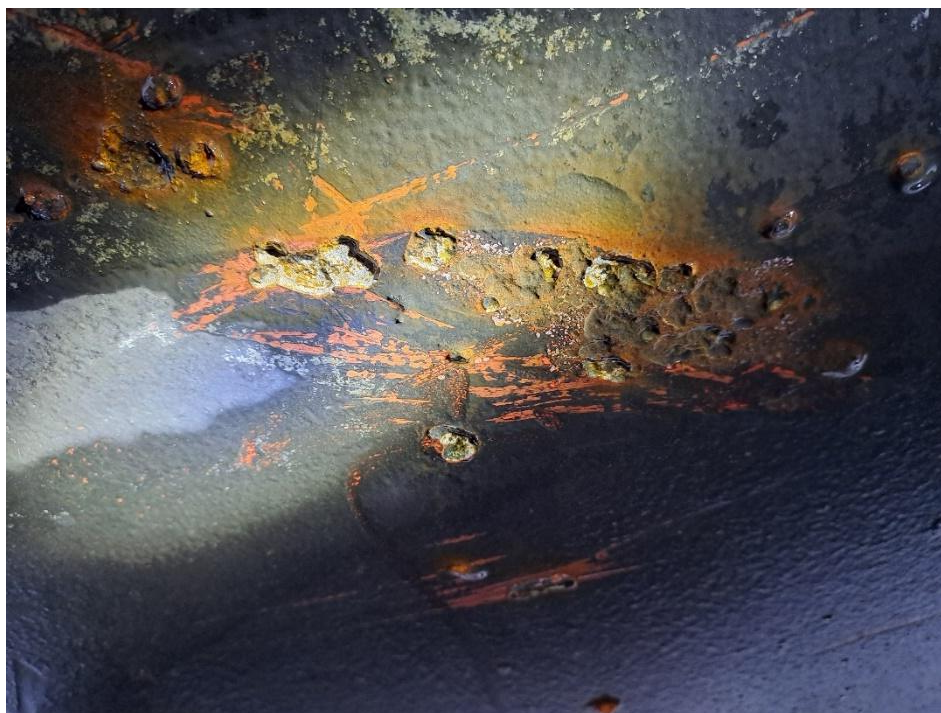
Piqûres et cloques de corrosion sur la coque de la faucardeuse
